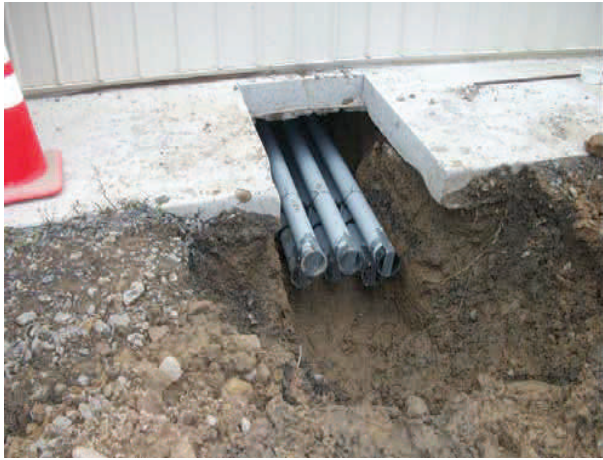
Power Control System Conduits
